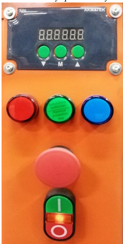
Рис. 1 Панель управления установки.
