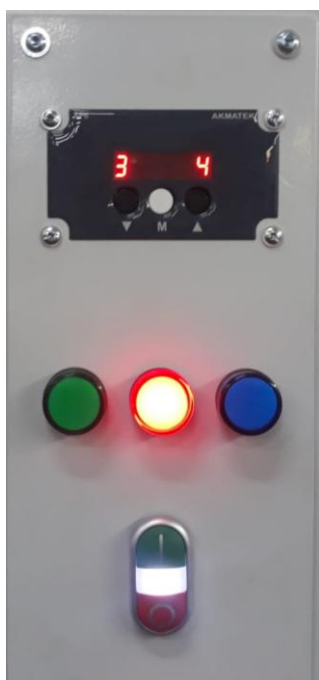
Рис. 1 Панель управления установки.
